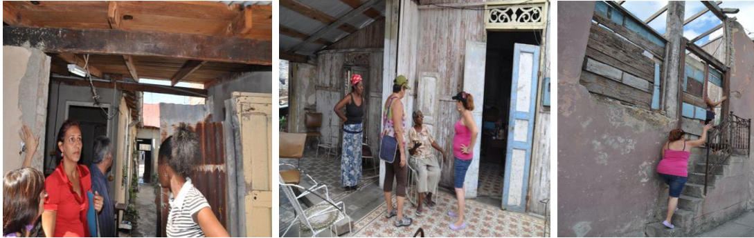
Abitazioni danneggiate ai tetti, alle reti idrosanitarie ed elettriche
