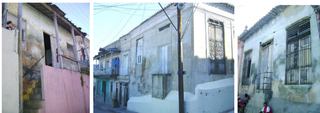
Facciate delle abitazioni danneggiate
